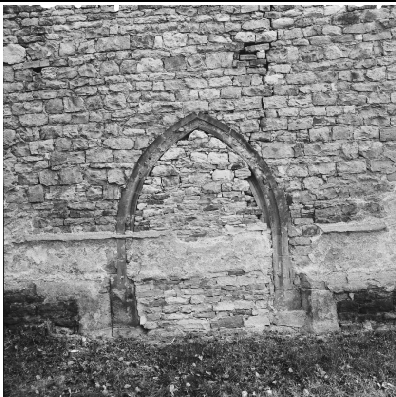
Čelní pohled od západu na zazděný západní hrotitý portál lodi na snímku z roku 1987. Zdroj: NPÚ ÚOP v Ústí n. L., Sběrka negativů, sign. 95901.
